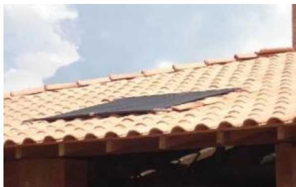
Figura 8. Placa de PVC, boiler e cobertura.
