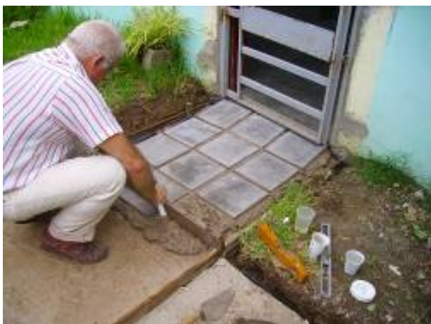
Construcción de pisos experimentales con contrapisos y pisos de baldosas con suelos estabilizados
